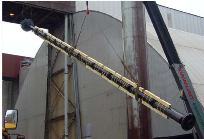
Şekil 54. 17m uzunluğundaki yüksek sıcaklık pompası (Anonim, 2011m)
