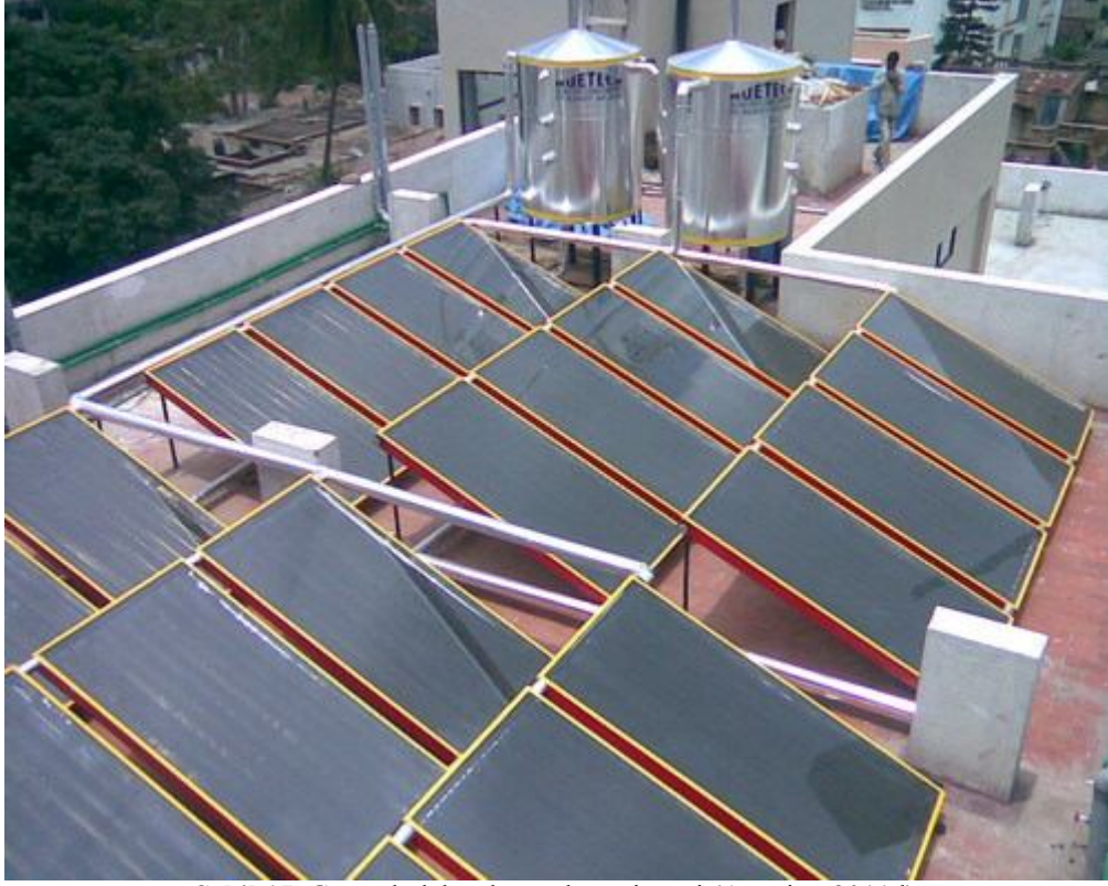
Şekil 15. Güneş kolektörlü sıcak su sistemi (Anonim, 2011d).
