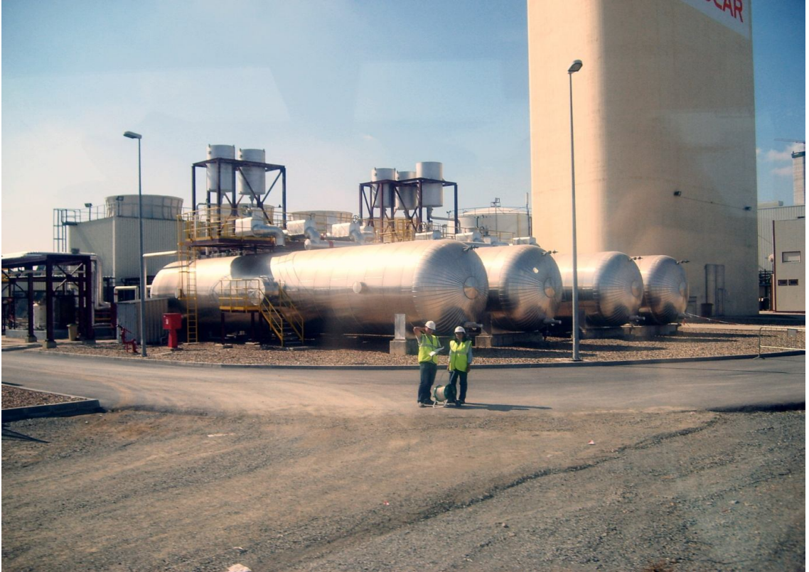
Şekil 37. CSP santrali ısı depolarının ve soğutma kulelerinin görünümü (Anonim, 2011k)
