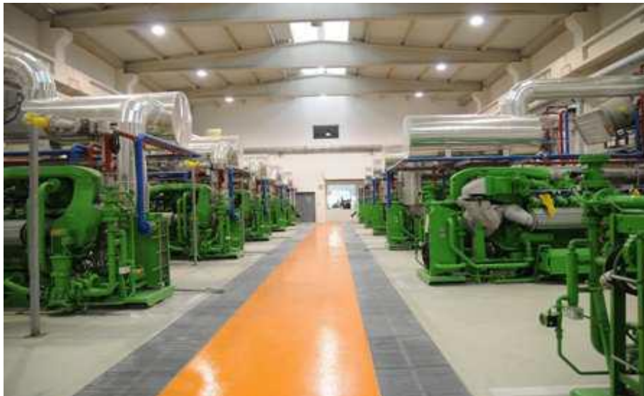
Şekil 10. İstanbul Kömürcüoda çöp gazı santrali
