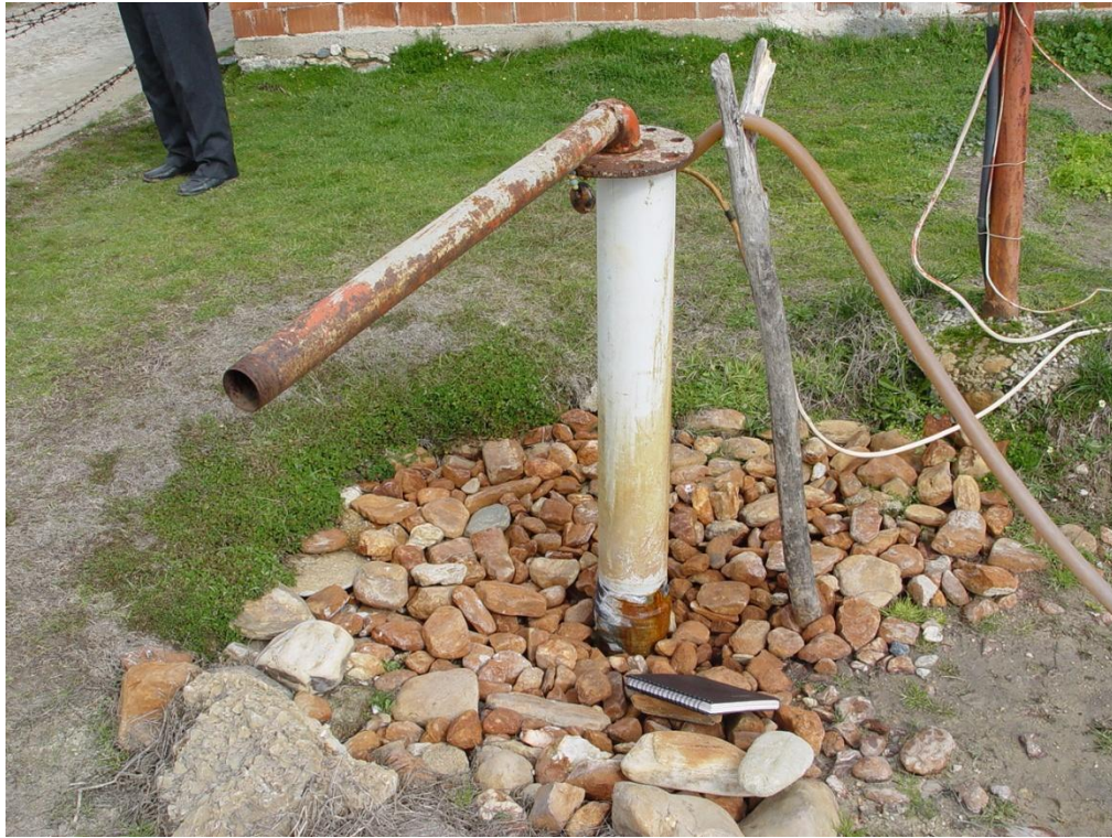
Şekil 4.59 Hisarardı YHS-1 kuyu başının yakından görünümü. Kuyu devamlı artezyen yapmaktadır. Çatalla desteklenen hortumla su dışarı edilmektedir.
