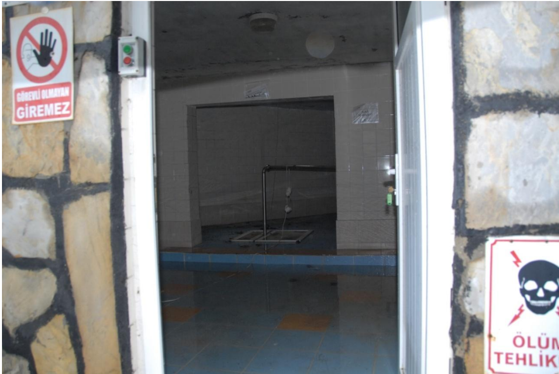
Şekil 4.47 Bozhöyük YBS-1 sondaj kuyusunun içi. Kuyudan zehirli gaz çıkışı olduğundan içine girilememiştir.
