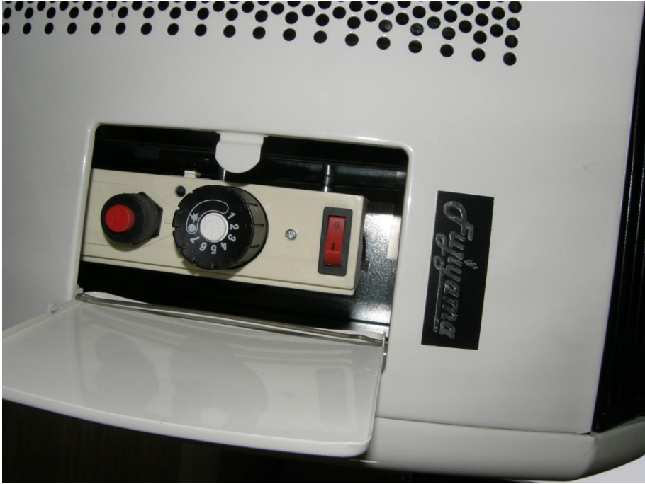
Resim 81 – Doğalgaz Sobası, Kontrol Paneli
