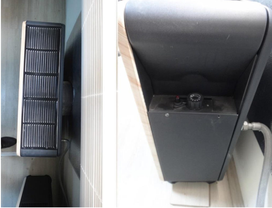
Resim 199 – Doğalgaz Sobası, Duvardaki Baca Bağlantısı ve Kontrol Paneli
