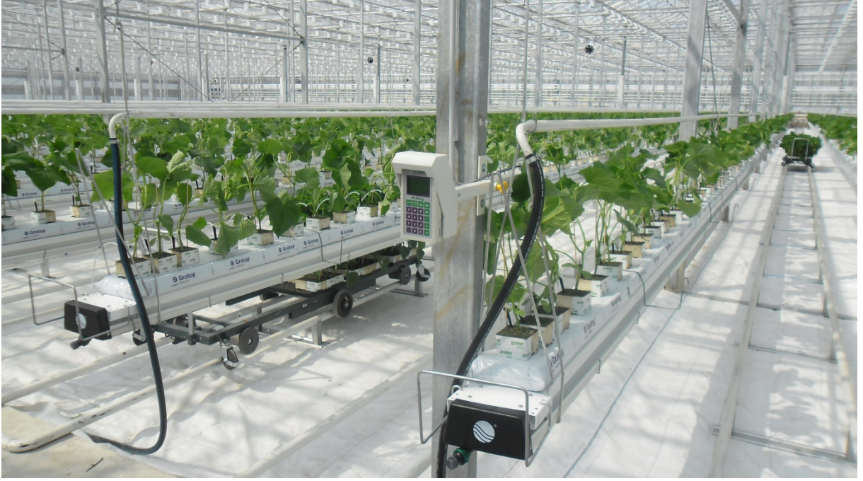
Ø38 Bitki ısıtma ve Ø51 taban ısıtma boruları
