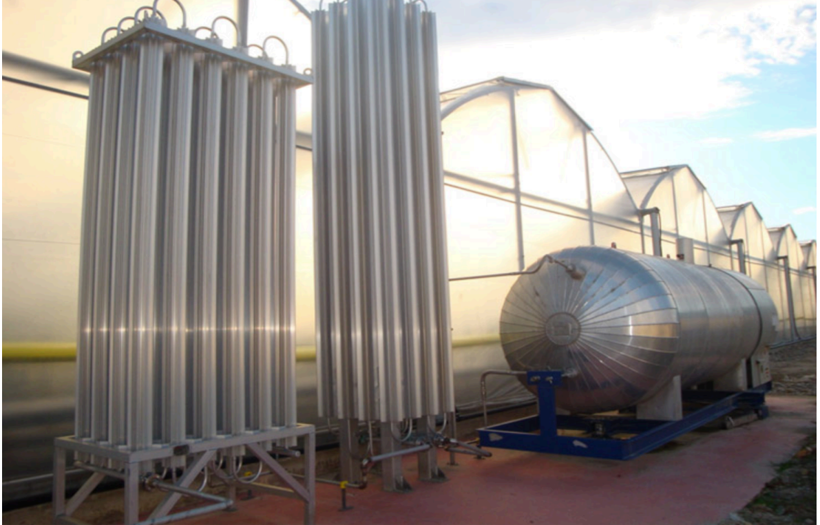
Sıvı CO 2 Tankı ve Evaporatör
