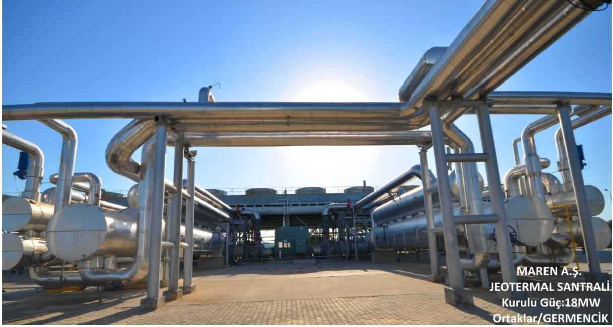
Resim 4. Jeotermal Enerji Santrali
